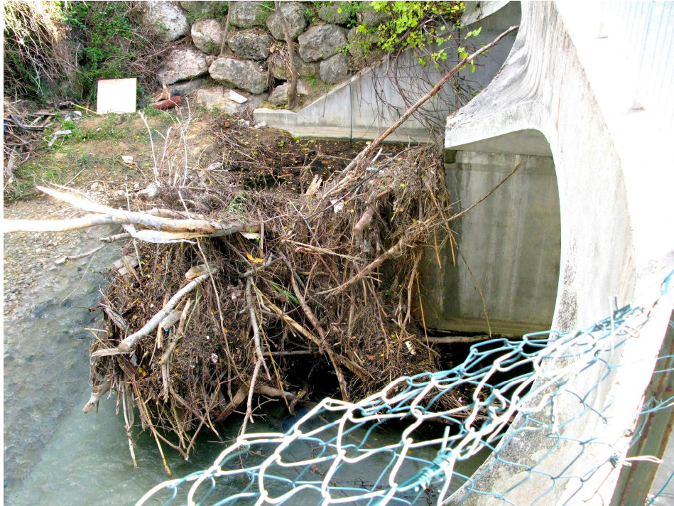
Photo 25 – Accès Carrefour – 2 arches circulaires accumulant les embâcles
