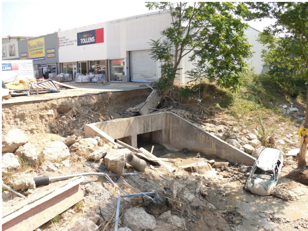
Photo 21 (DDTM) - Retour des eaux à la Nartuby au droit de la voie Pompidou
