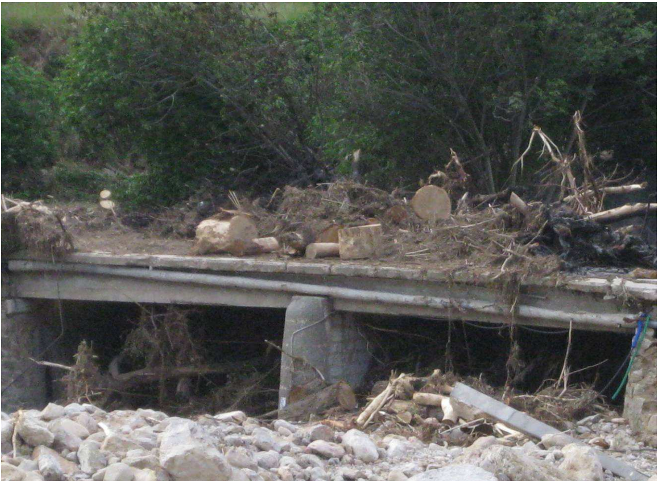
Photo 15 : Pont colmaté par les arbres vu d'aval.
