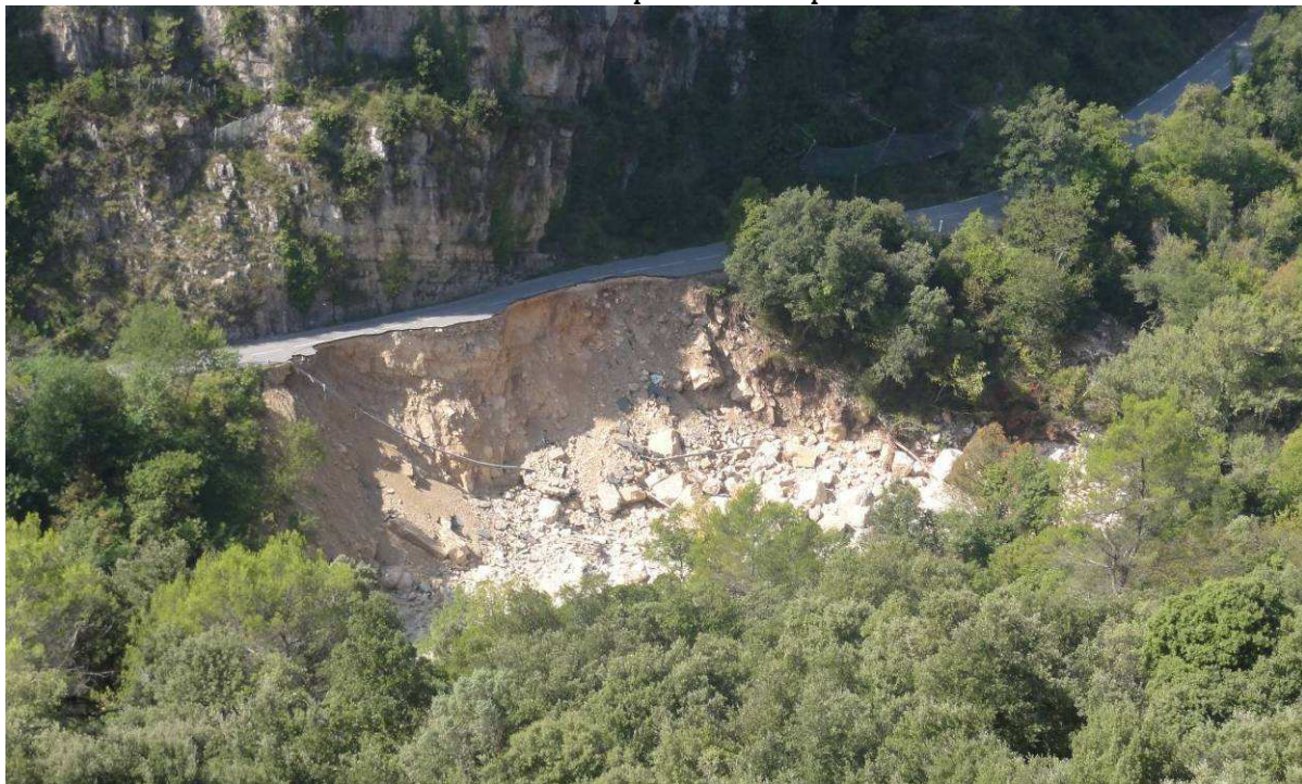
Photo 9 : Affouillement de la plate-forme de la route par la Nartuby.
