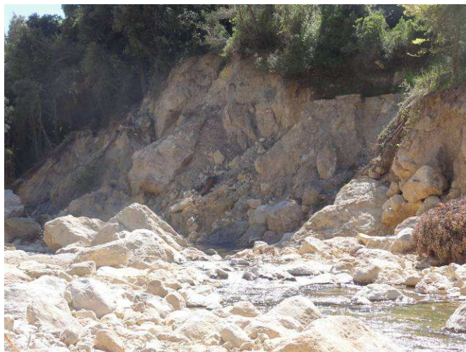
Photo 13 : Affouillement du canal rive droite.
