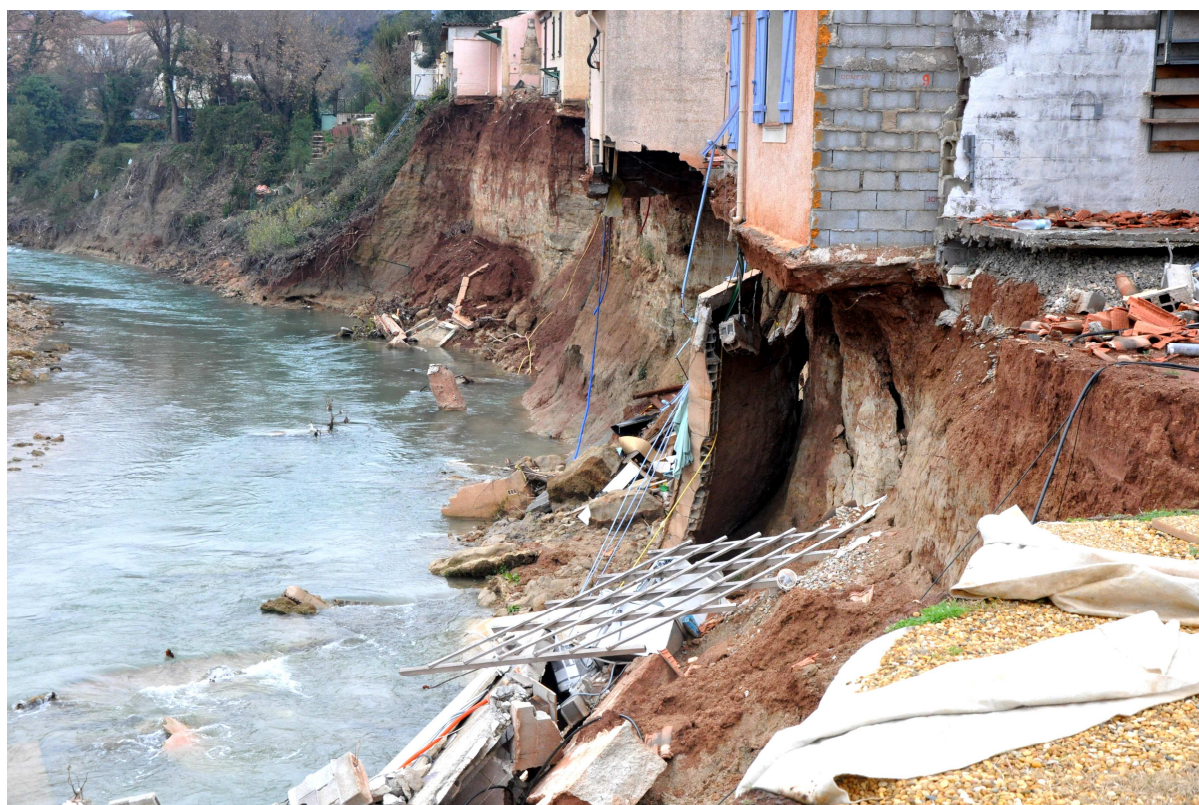
Photo 32 - Vue d'aval : maison effondrée au premier plan
