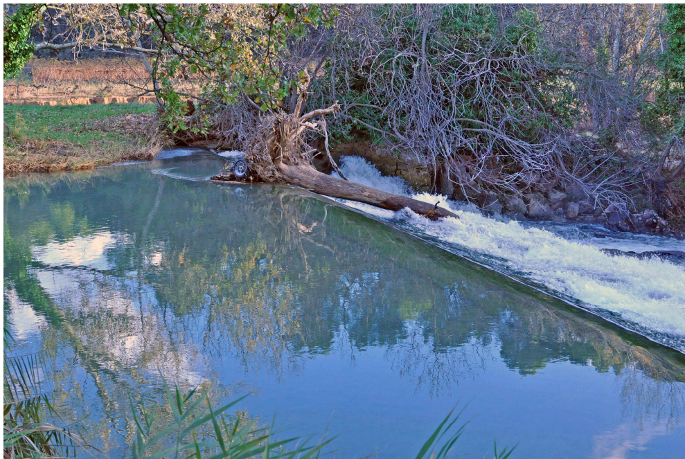
Photo 30 - Seuil de prise d'eau EDF – Au fond, griffe d'érosion provoquée par le contournement en rive gauche
